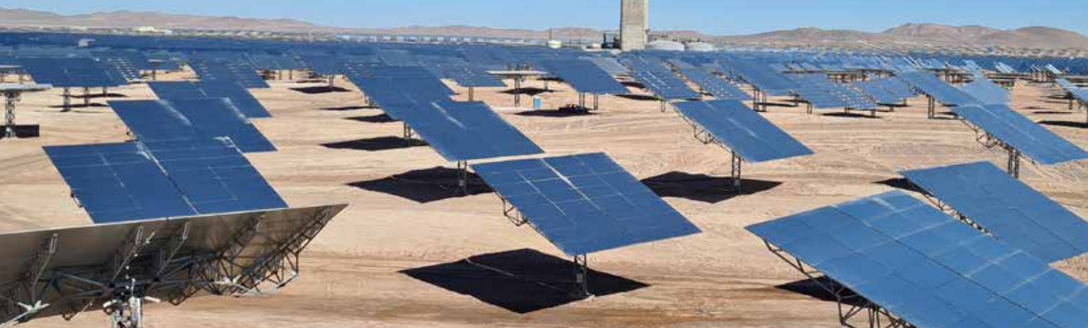
První termosolární elektrárna v Latinské Americe – Cerro Dominador, kam dodávaly české firmy parní turbínu a výkonový transformátor
