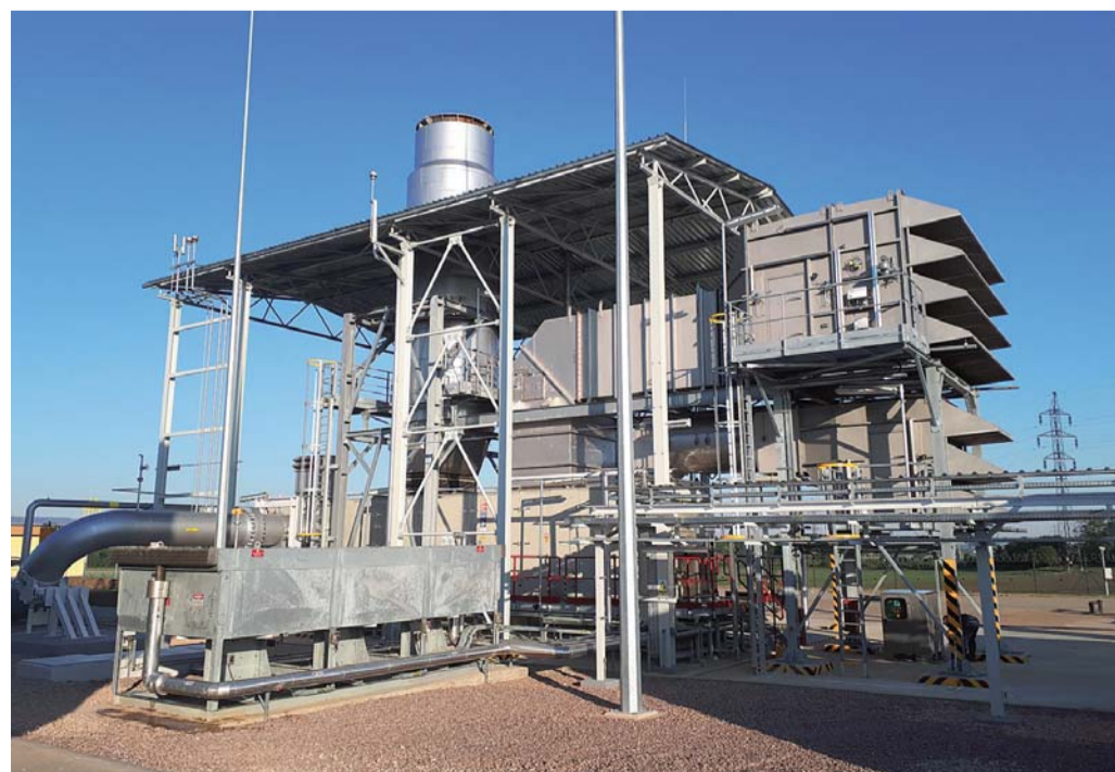
GASCONTROL instaloval turbosoustroj v kompresorových stanicích Kouřim a Břeclav
