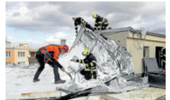
NA PANELOVÉM DOMĚ v Plzeňské ulici v Klatovech utrhł včerejší vítr střechu. Foto: HZS PK
